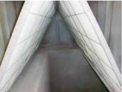
汚れた排気フィルター
